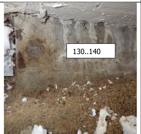
Kuva 8. RT2. Kuva otettu alapohjatilasta. Pystyosa on betonipilaria. Yläreunassa näkyy alapohjalaatan alapinta. Pilarin kohdalta on poistettu alapohjan lämmöneriste. Pintakosteusosoittimen lukema pilarissa oli 130..140.
