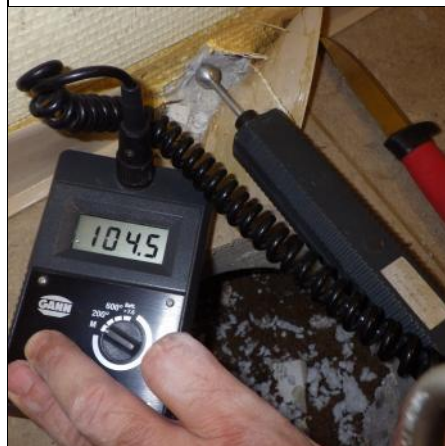
Kuva 7. RT2. Pilarin kohdalla muovisen jalkalistan takana rakenteen kosteus koholla.
