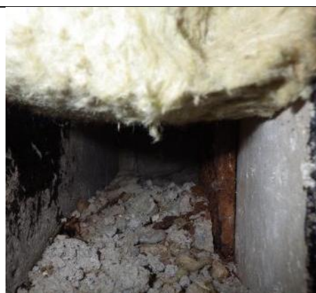
Kuva 4. Ulkoseinän rakennetutkimuskohta huoneessa 144 (4). Pilarin juuresta puuttuu lämmöneriste.
